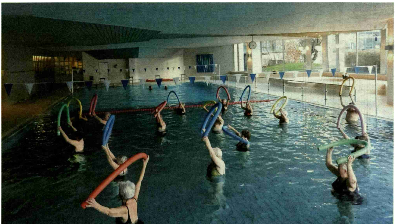
Die Decke im Hallenbad Aadorf soll nicht wie ein Damoklesschwert über den Köpfen schweben.
